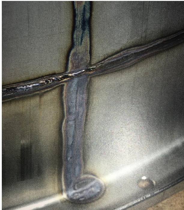
Slika 18: Pobojenost površine uzrokovana djelovanjem topline prilikom zavarivanja [29]
