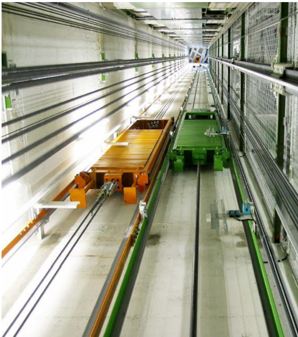
Slika 6.6. Vodilice i protutezi Twin liftova ThyssenKrupp
