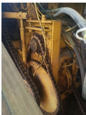
Slika 2.7. Zatečeno stanje mehaničkog dijela pogona
