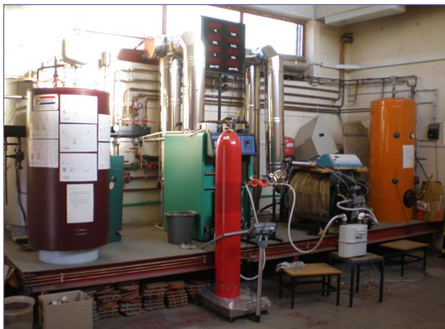
Slika 5.2 Ispitna linija za ispitivanje kotlova u Laboratoriju za toplinu i toplinske uređaje
