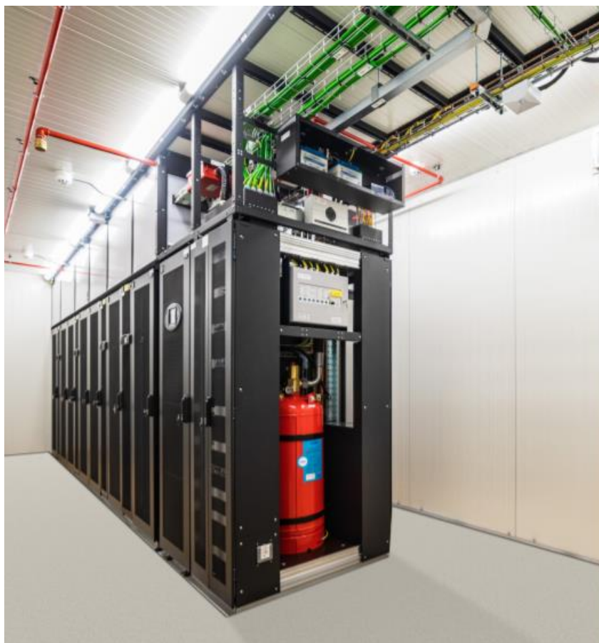
Slika 7. Unutrašnjost podatkovnog centra [13]
