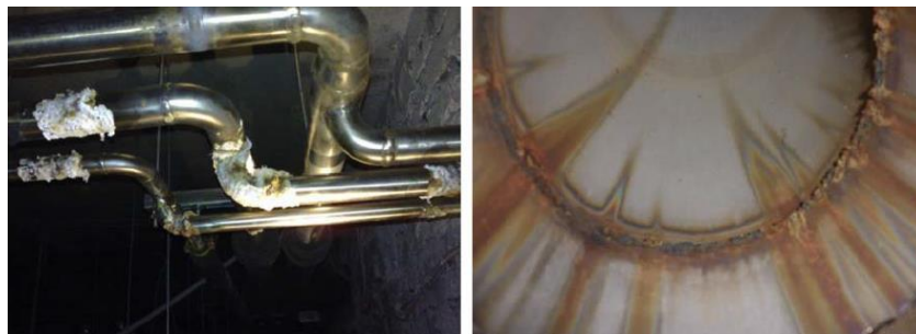
Slika 45. Oštećenje cjevovoda (lijevo) i spremnika za vodu (desno) [37]
