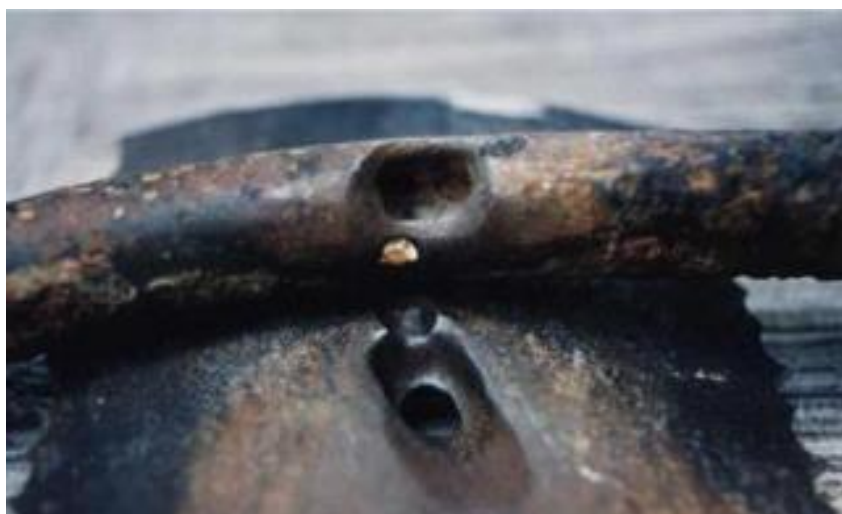
Slika 13. Korozija plinovoda u Guadalajari, Meksiko [15]
