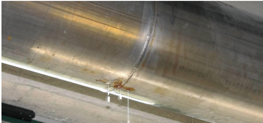
Slika 30. Propuštanje vode u području zavara na čeliku EN 1.4307 izazvano MIC-om [33]
