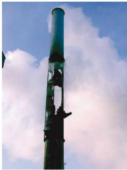
Slika 11. Strukturno nestabilan dimovod [13]
