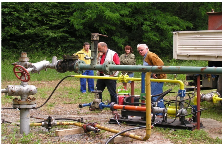
Slika 15 Ispitivanje na površini zemlje s metanom kao radnim fluidom na naftnom polju Šandrovac
