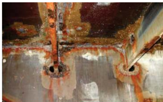
Slika 2.10 - Uznapredovala korozija potpalublja 20 godina starog tankera
