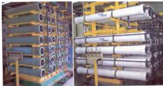
Slika 9. RO moduli u postrojenju za desalinizaciju
