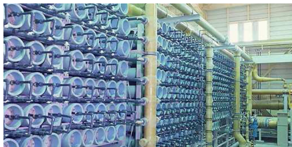
Slika 10. RO moduli u postrojenju za desalinizaciju
