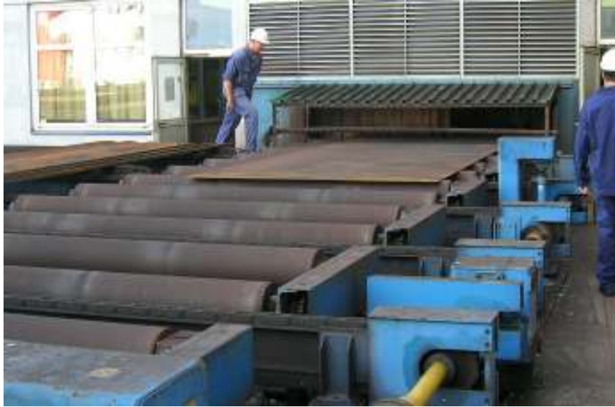
Slika 7. Valjčasta staza na ulazu u predobradu
