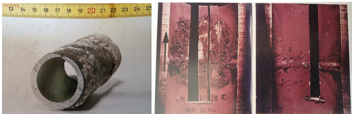
Slika 2. Primjeri kemijske korozije [4]
