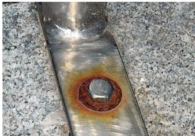
Slika 6. Primjer galvanske korozije [9]
