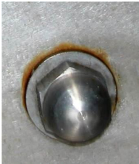
Slika 8. Primjer korozije u procjepu [13]
