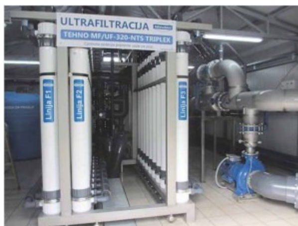
Slika 4: Primjena procesa ultrafiltracije za dobivanje kakvoće vode za ljudsku potrošnju
