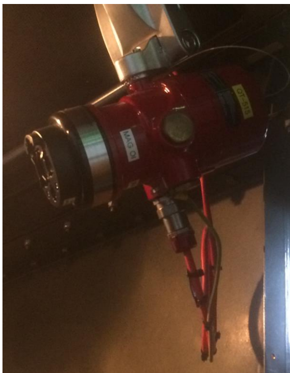
Slika 26. Kamera za detekciju požara
