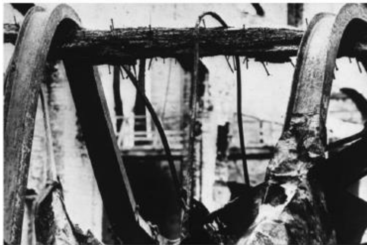
Slika 3.14. Drveni i čelični nosači nakon požara [7]
