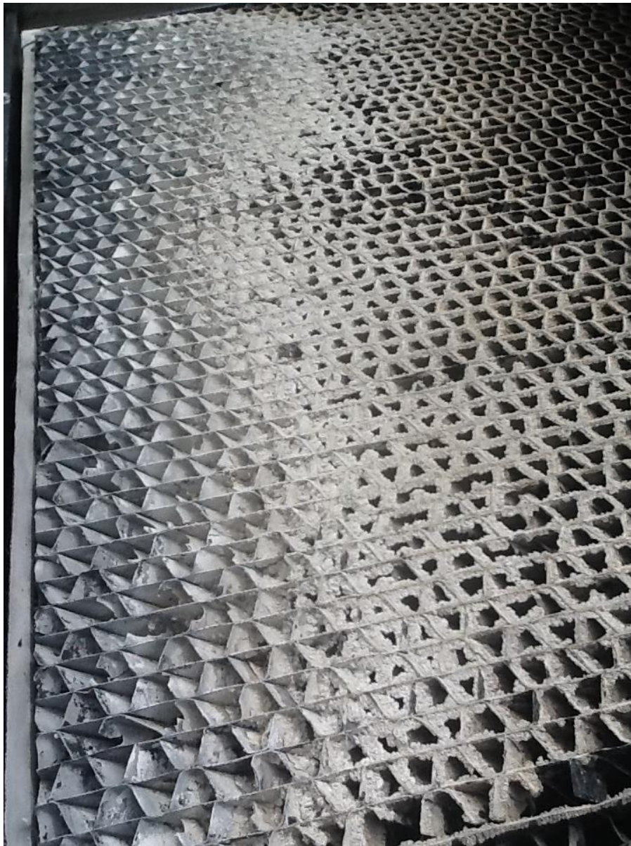
Slika 11: jasno vidljive naslage kamenca na saću rashladnog tornja [5]
