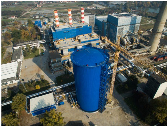
Slika 5. Kratkoročni spremnik topline u TE-TO Zagreb [7]
