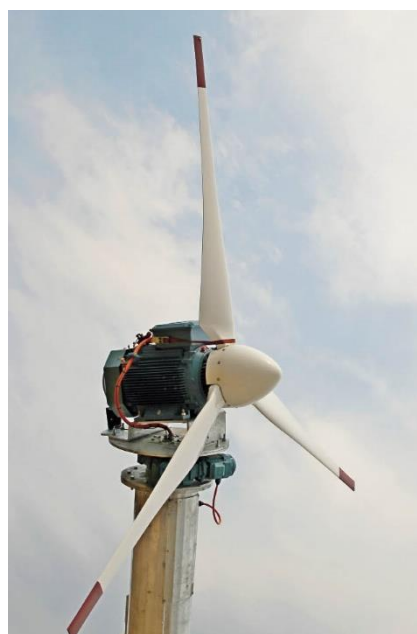
Slika 3.3. AGI FROST ventilator
