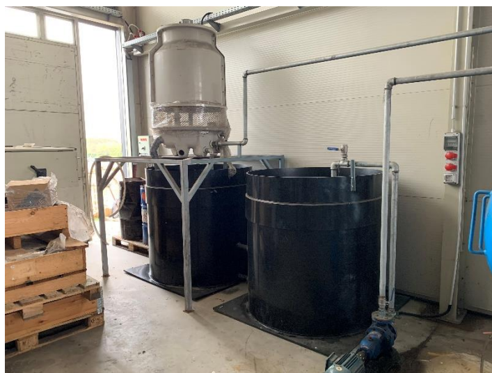
Slika 51. Spremnici i uređaj za hlađenje vode
