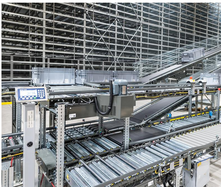
Slika 1. Primjer dijela transportnog sustava automatiziranog skladišta
