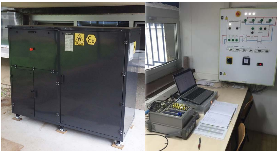
Slika 4-3 Dizalica topline s integriranim hidrauličkim modulom (lijevo) te akvizicijski sustav i elektro-regulacijski ormar u Tehničkoj sobi (desno)
