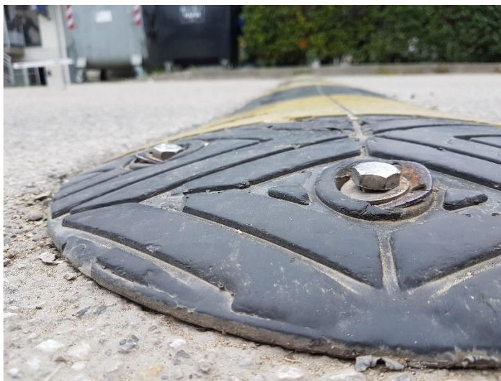
Slika 35. Nepravilno postavljena umjetna izbočina u Dobojskoj ulici
