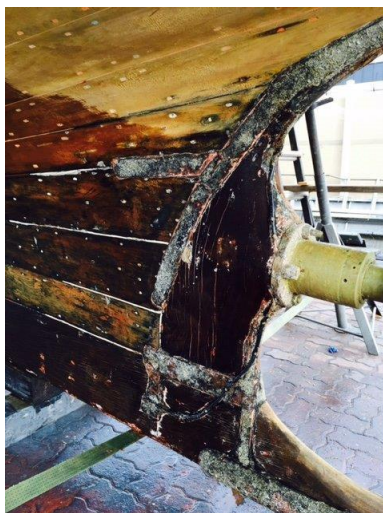
Slika 16: Utjecaj korozije na drvenu konstrukciju.
