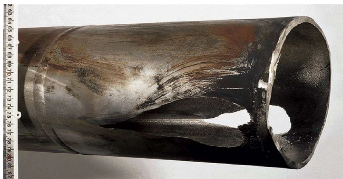
Slika 6. Prikaz erozijske korozije legure Hastelloy C-276 [19]
