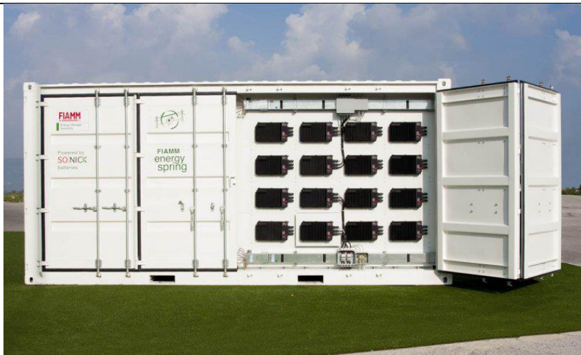
Slika 28. Kontejner za skladištenje električne energije u baterijama [26]
