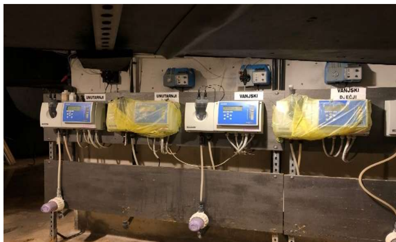
Slika 35. Postrojenje za dodavanje klora u bazensku vodu
