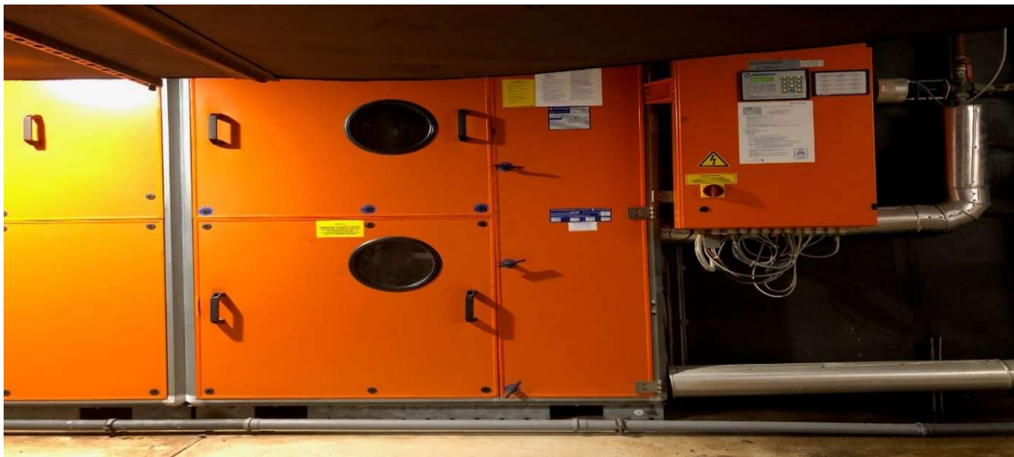
Slika 38. Slika klima-komore na objektu
