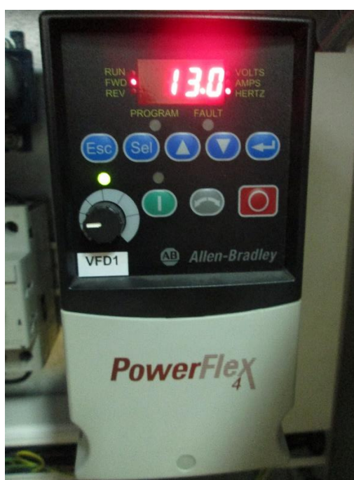
Slika 6. Allen-Bradley PowerFlex 4 upravljačka jedinica.
