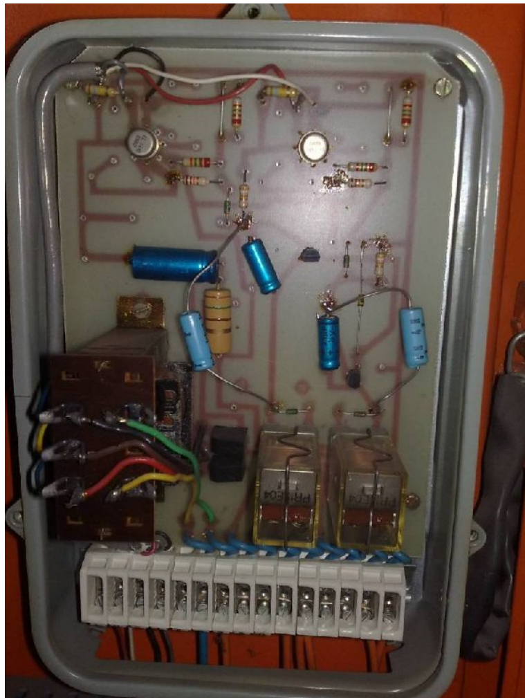
Slika 17. Sklop električnih komponenti za upravljanje radom elektromotora na osnovu signala induktivnog davača brzine vrtnje pomoćnog (srednjeg) valjka
