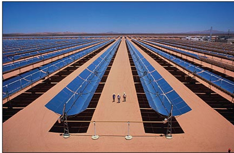
Slika 13. Parabolična protočna solarna termoelektrana
