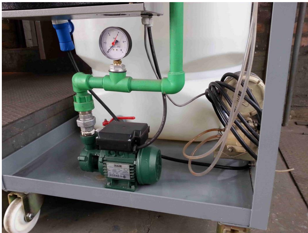
Slika 5. Pogonska pumpa, rezervoar i cijev za protok vode
