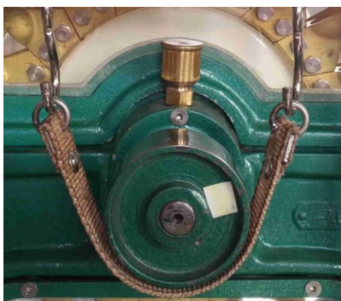
Slika 23. Prednji kraj vratila Pelton turbine sa bijelim reflektirajućim markerom
