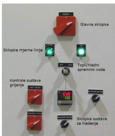
Slika 26. Prikaz prekidača na elektro-ormariću ispitne linije
