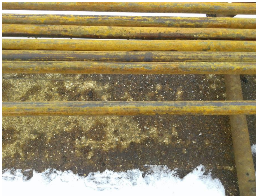
Slika 4. Primjer oštećenja na crpnoj cijevi uzrokovanog korozijom, vanjsko oštećenje (naftno polje Žutica)
