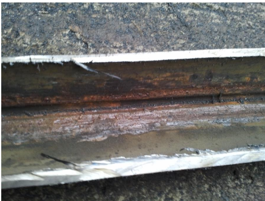
Slika 6. Primjer oštećenja na crpnoj cijevi uzrokovanog trenjem šipke, unutarnja oštećenja (naftno polje Žutica)
