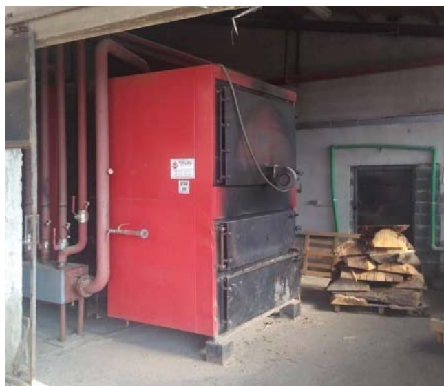
Slika 21. Kotao u kotlovnici pilane [17]
