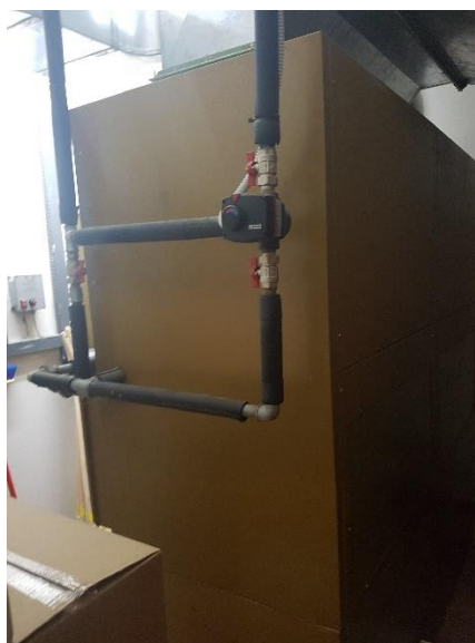
Slika 3.6 Klima ormar u zgradi gradske uprave Grada Kaštela (prosinac, 2018.)
