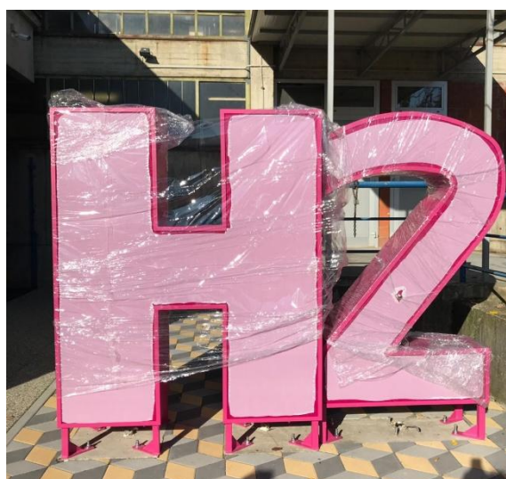
Slika 18. Kućište punionice vodika instalirano na lokaciji
