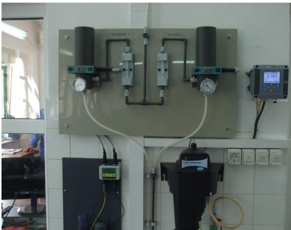
Slika 22. Kontrolna ploča u postrojenju za kemijsku dezinfekciju vode s vrijednošću SRK u vodoopskrbnoj mreži [7]
