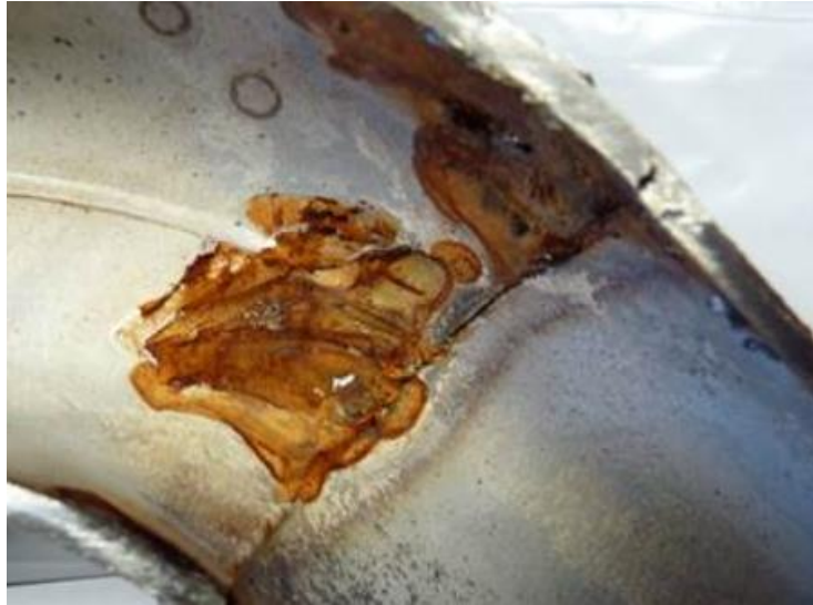
Slika 21. Primjer korozije u procjepu kod cijevi nehrđajućeg čelika AISI 304L [24]
