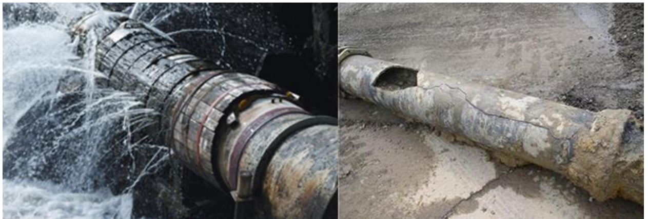
Slika 1 – Puknuće cijevi uzrokovano hidrauličkim udarom [1]
