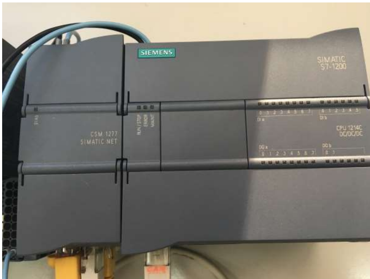
Slika 12. Siemens PLC S7-1200 spojen s modulom CSM 1277
