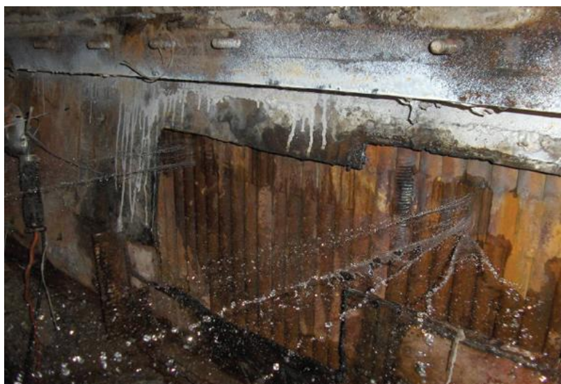
Slika 6: Propuštanje na spoju cijevi i kolektora uzrokovano temperaturnom ekspanzijom [7]
