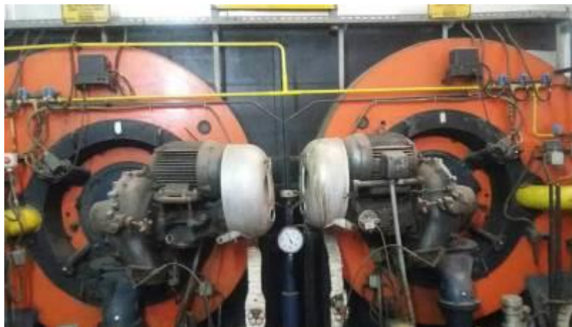
Slika 20. Gorionici u energani tvornice šećera [10]
