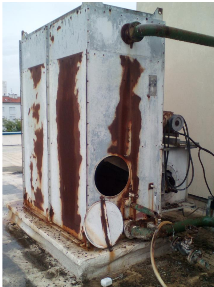
Slika 5. Neodržavani evaporativni kondenzator
