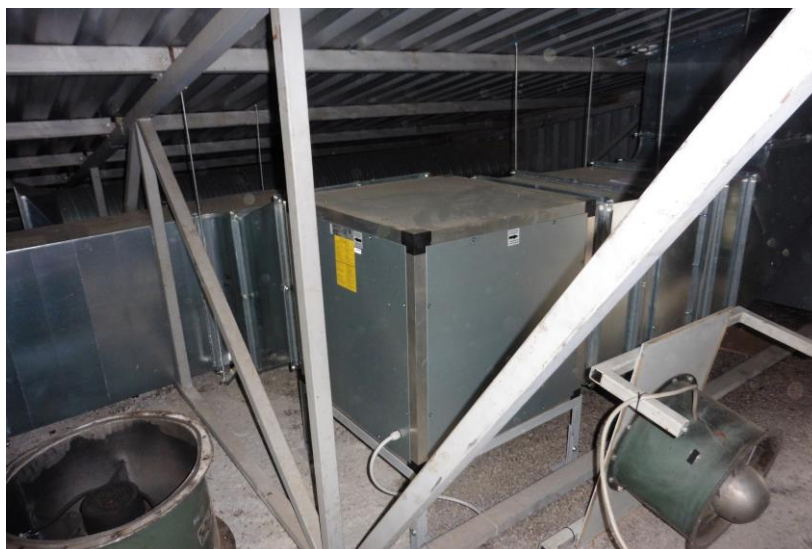
Slika 3.5 Postojeći ventilator za dovođenje zraka
