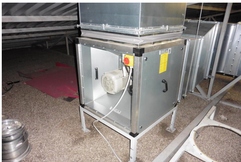
Slika 3.6 Postojeći ventilator za odvođenje zraka
