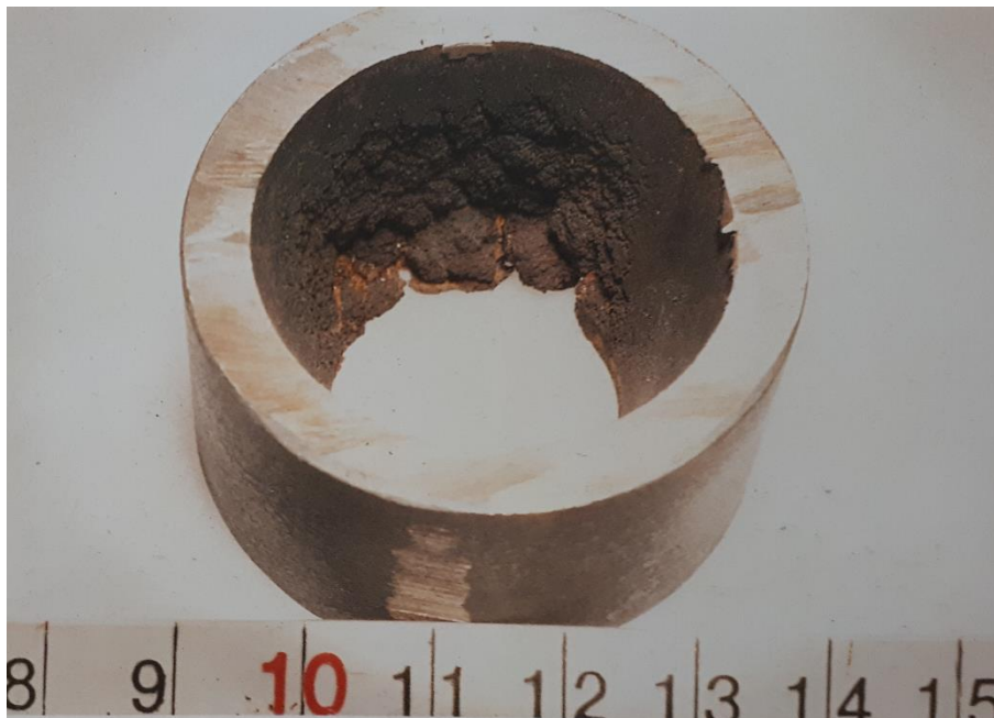
Slika 26: Politionska napetosna korozija na nehrđajućem čeliku kvalitete AISI 304 H [3]
