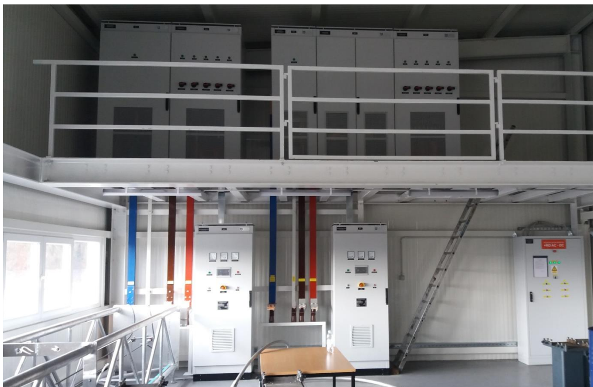
Slika 6. Oprema za električna ispitivanja
