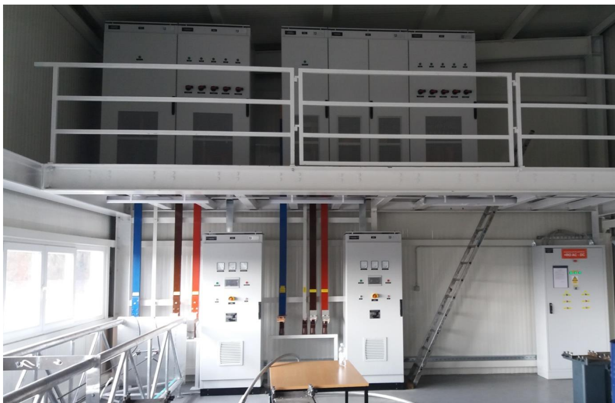
Slika 6. Oprema za električna ispitivanja
