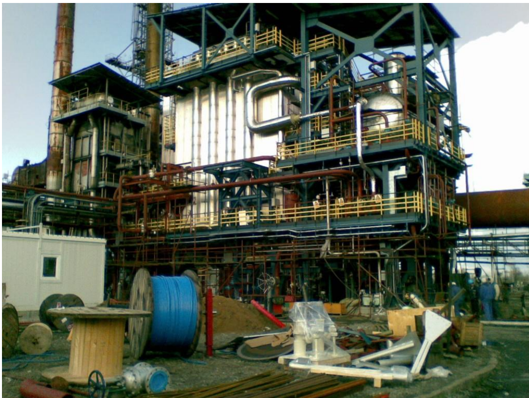
Slika 1 Generator pare u INA Rafineriji nafte Sisak
