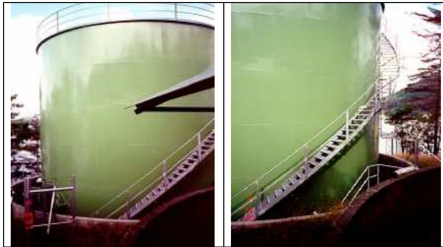
Slika 33. Spremnik za naftu zaštićen hibridnim premaznim sistemom [12]
