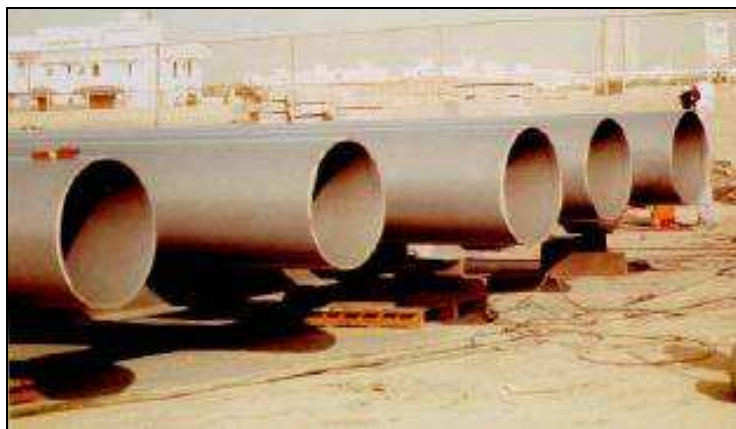
Slika 34. Cjevovod za plin zaštićen hibridnim premaznim sistemom [12]
