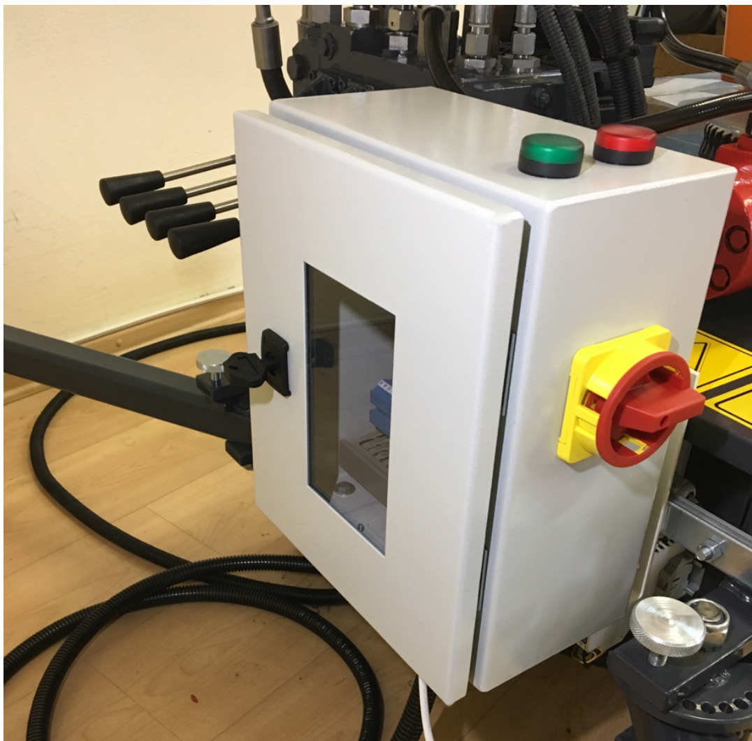
Slika 39. Upravljački ormar ugrađen na manipulator
