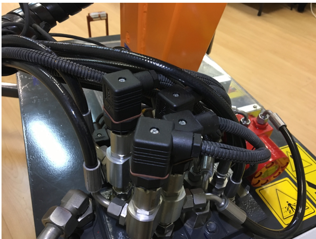
Slika 17. Ugrađeni senzori tlaka
