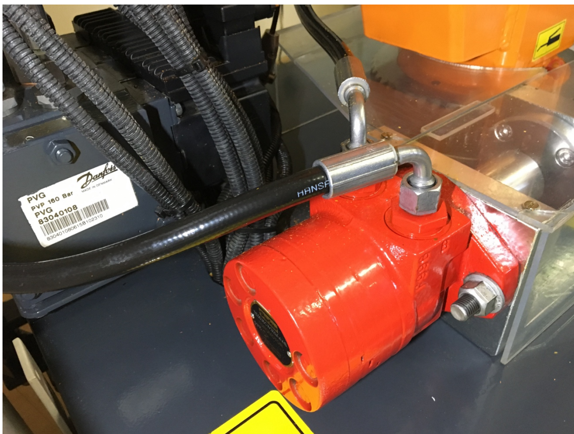
Slika 4. Ugrađeni Parker hidromotor
