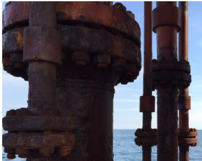
Slika 3. Primjer opće ravnomjerne korozije na platformi Ida C [2]
