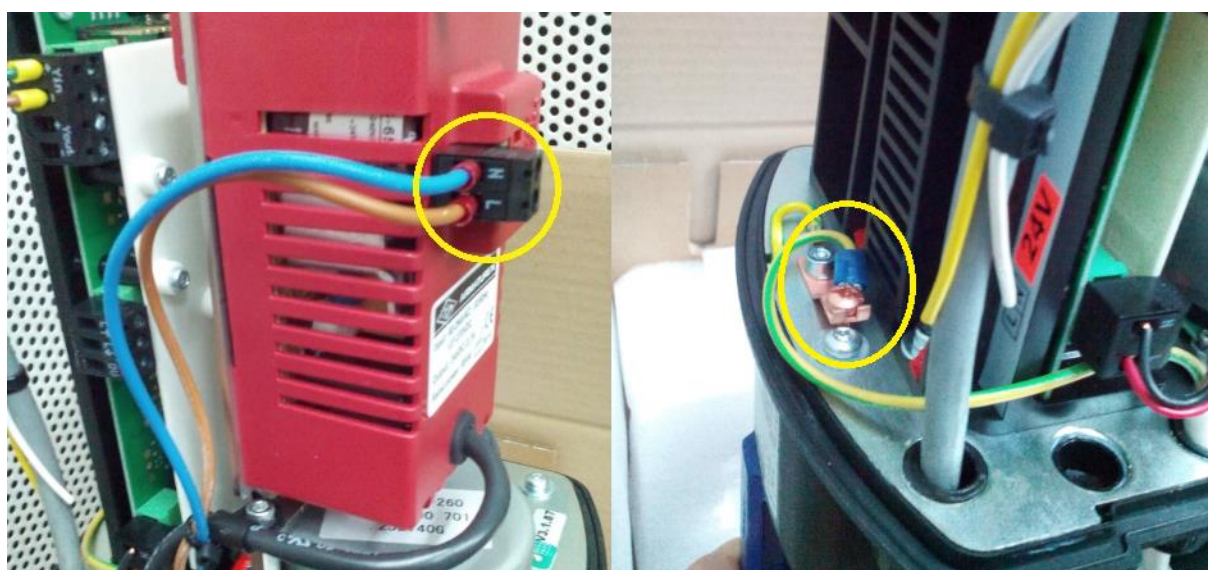
Slika 3.10. Spajanje napajanja na transformator.
